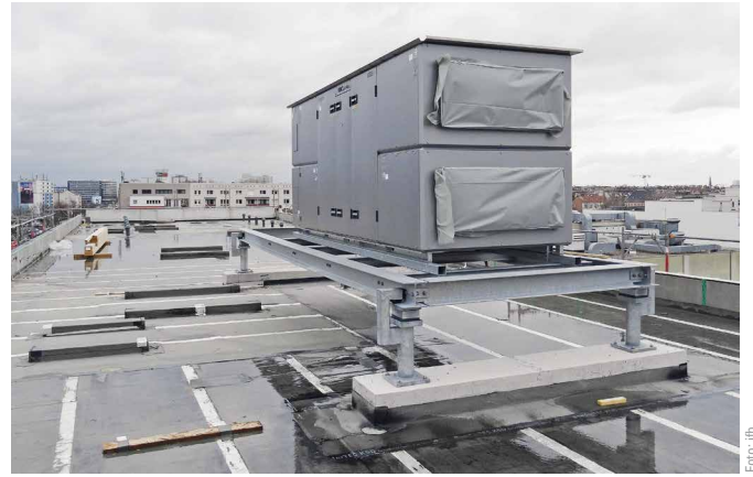
Bild 14 Schwingungstechnisch entkoppeltes Lüftungsgerät auf dem Dach
